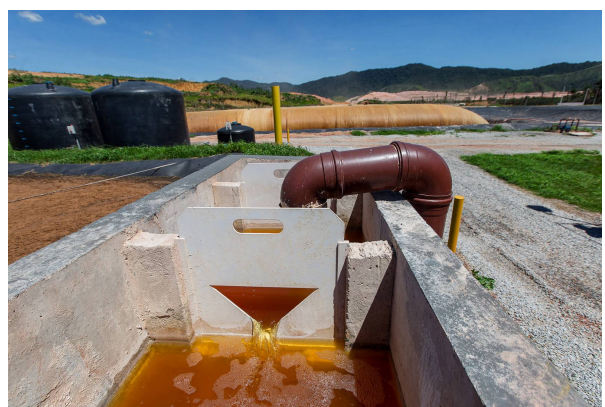
Figure 15: Transforming the leachate into reusable water. Sources: Cidade Olímpica. CTR Seropédica . Accessed in 2015. http://www.cidadeolimpica.com.br/academia-da-terceira-idade-2/
