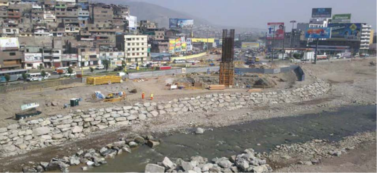
Figure 76: Rímac River provisional protection dikes during L1ML's construction / Source: MTC and Consorcio Tren Eléctrico, Memoria Descriptiva de las Obras Provisionales en el Lecho del Río Rímac, p. 8.
