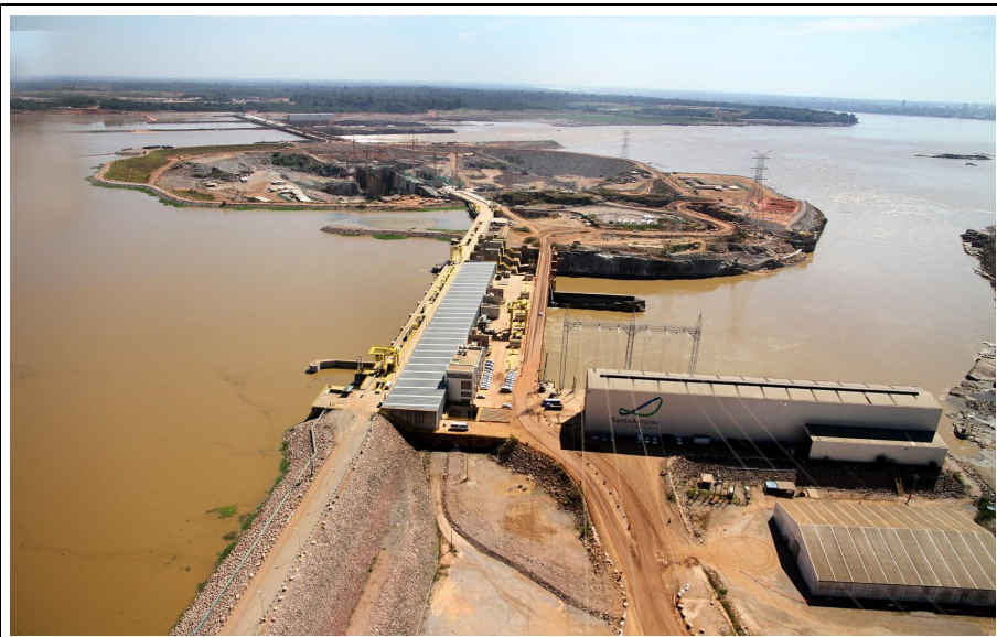
Figura 01: Imagen general de la planta hidroeléctrica de Santo Antônio Fuentes: Santo Antônio Energía
