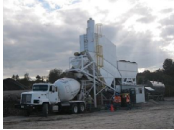
Figure 18: Wind farm's concrete plant. Source: EEHSA, Informe de Cumplimiento de Medidas Ambientales ICMA, p. 16
