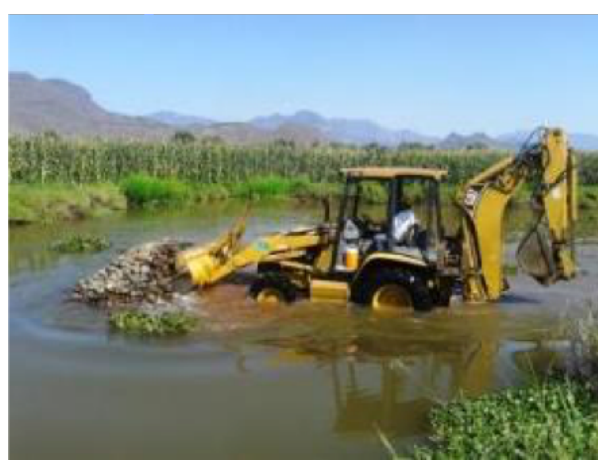
Figure 22 : Central Hidroeléctrica El Gallo, en Guerrero México; Soil removal in a waterway.
