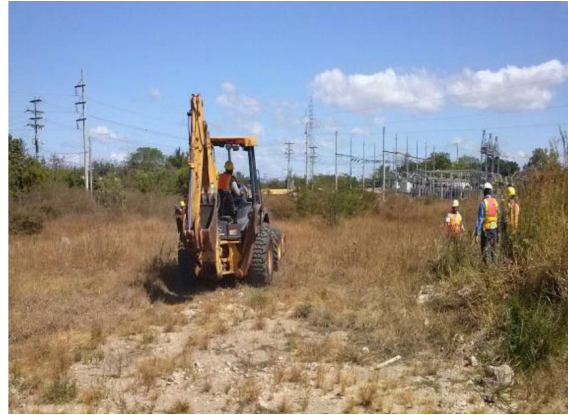
Figura 28: Eliminación de la capa superior del suelo y traslado de la fauna. Fuentes: Cobra, Reporte Fotográfico: Proyecto Ampliación de la Sub Estación Santa Lucía 230 kv y 34.5 kv (2015), 2.
