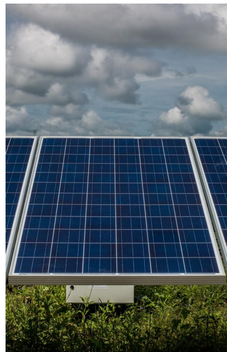
Figura 36: Plano de los módulos fotovoltaicos. Fuentes: Anexo Fotográfico.
