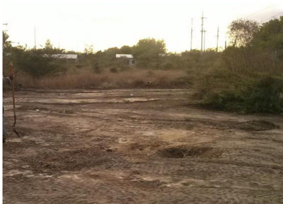
Figura 30: Condiciones de campo el 5 de enero del 2015. Fuentes: Cobra, Reporte Fotográfico: Proyecto Ampliación de la Sub Estación Santa Lucía 230 kv y 34.5 kv (2015), 3.
