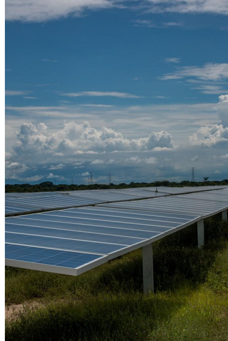
Figura 34: Relación de los módulos fotovoltaicos al suelo. Fuentes: Anexo Fotográfico.
