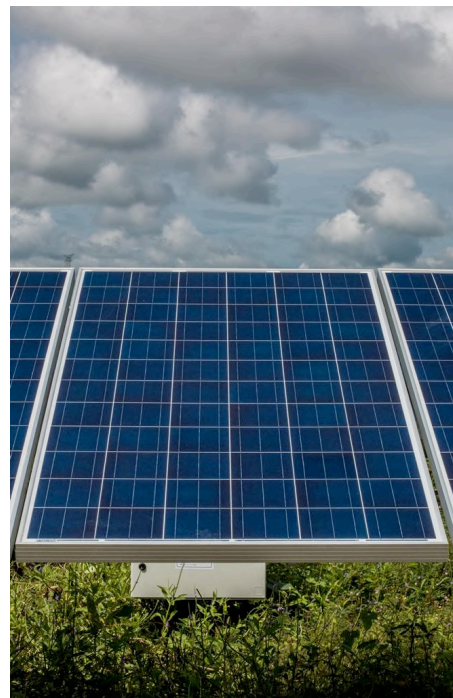
Figure 36: Photovoltaic Modules Layout. Sources: Anexo Fotográfico .
