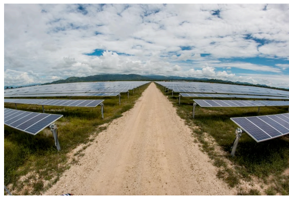
Figure 32: Photovoltaic Modules Layout. Sources: Anexo Fotográfico .
