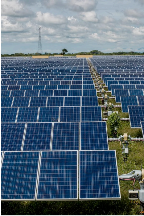
Figure 33: Photovoltaic Modules Layout. Sources: Anexo Fotográfico .
