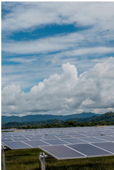
Figure 35: Photovoltaic Modules Layout. Sources: Anexo Fotográfico .
