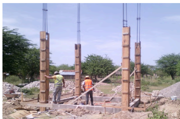
Figure 13: Construction of water tank in San José de la Landa. Sources: Clever Honduras, Informe de Avance Social de Sitio Pacífico I, Choluteca I y II . Semana del 25 de junio al 01 de julio del 2015 (Choluteca, 2015), 5.
