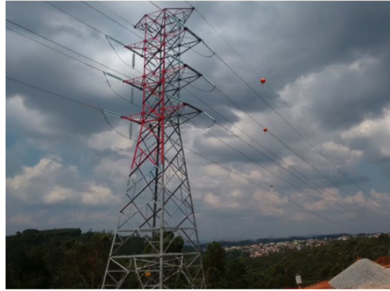
Figure 15: Transmission Line 138kV Sources: Solví Valorização Energética.
