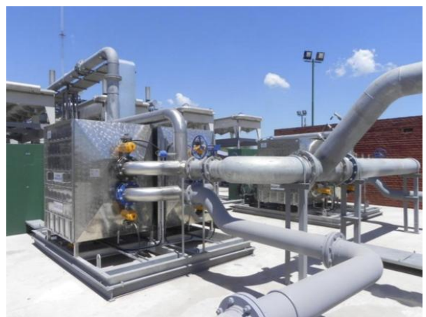
Figura 11: Planta de Eliminación de Siloxano.
