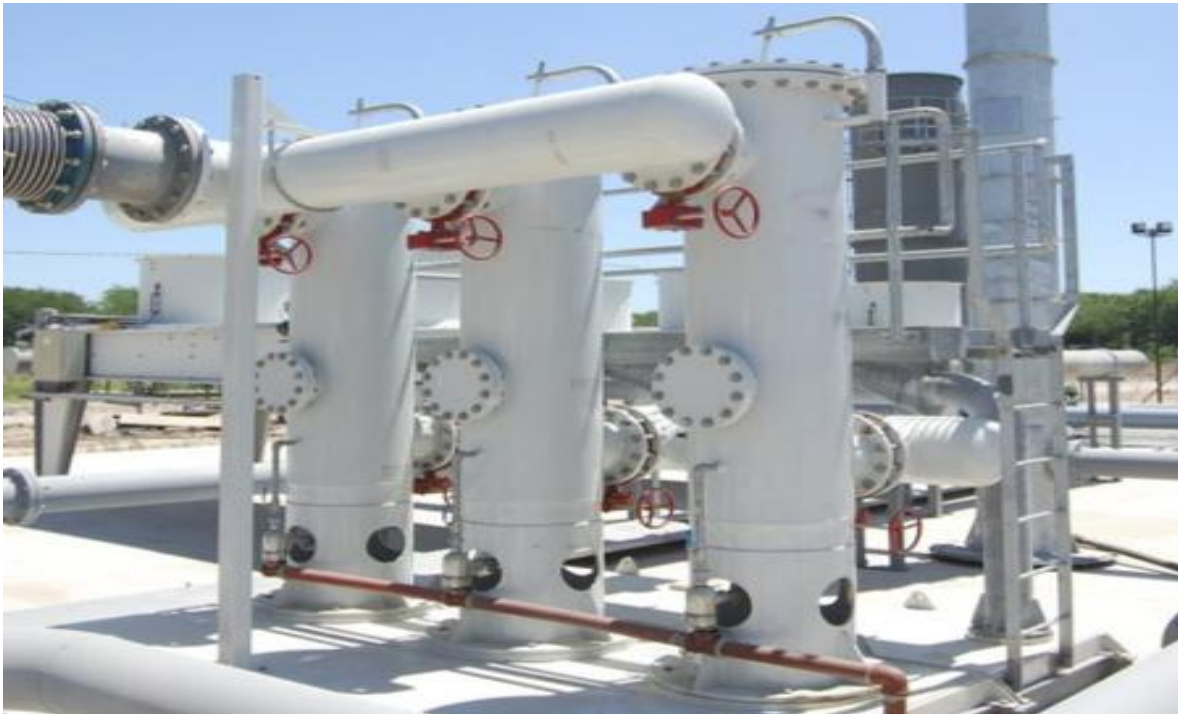
Figura 12: Sistema de Enfriamiento.
