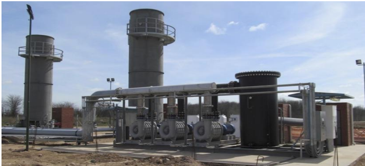
Figura 13: Sistema de Captación [Recuperación?] de Biogás.
