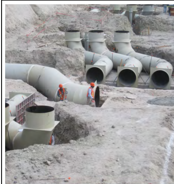
Figura 14: Foto de las obras de construcción. Fuentes: SEMARNAT. Planta de Tratamiento de Aguas Residuales Atotonilco . México: 2014.
