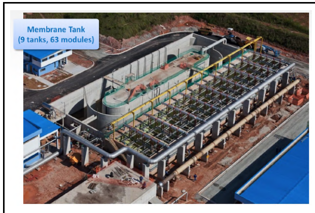
Figure 19: Membrane tanks. Sources: Aquapolo Ambiental, Apresentação geral.
