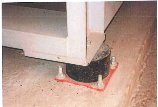
Figure 34: Noise and vibration adjustments. Sources: Aquapolo Ambiental S.A., Laudo técnico de Avaliação de Vibrações em Áreas habitadas (June 22, 2012).
